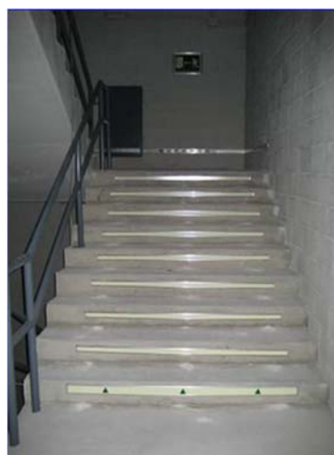
Figura 45 - Balizamiento foto luminiscente en interior salida de emergencia
