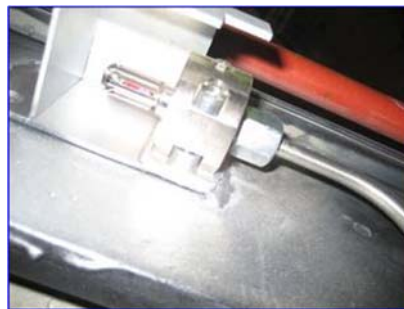
Figura 14 - Boquilla pilotaje térmico escalera mecánica
