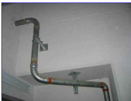
Figura 30 - Tubería acero galvanizado 3''
