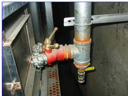
Figura 27 - Bocas siamesas y válvula vaciado
