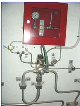
Figura 15 - Válvula extinción NS20 escalera mecánica
