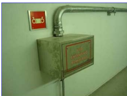
Figura 28 - Armario acero inoxidable con bocas siamesas en salida de emergencia de túnel
