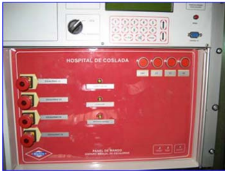
Figura 21 - Panel maestro extinción
