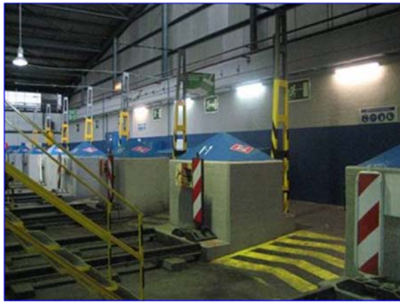
Figura 60 - Carteles evacuación en zona de estacionamiento de trenes
