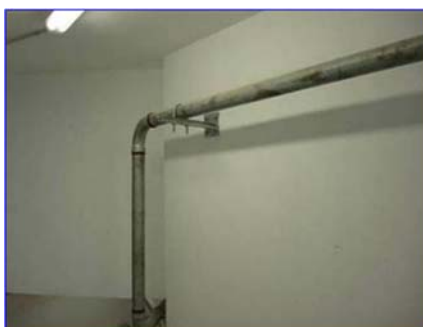
Figura 29 - Tubería acero galvanizado 3''
