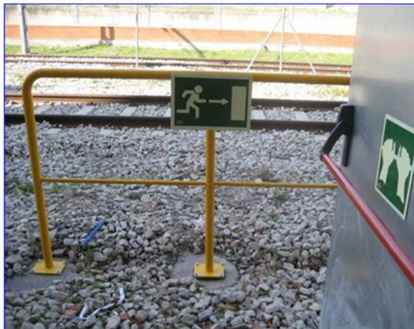
Figura 62 - Carteles fotoluminiscentes en salida de emergencia
