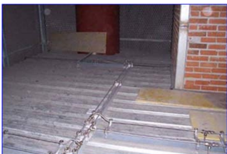
Figura 19 - Tuberías acero inoxidable y soportaciones
