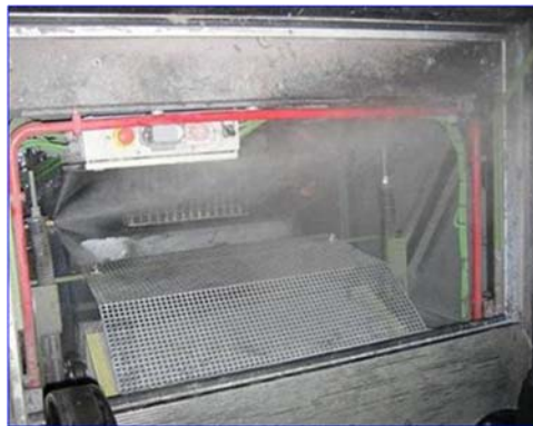
Figura 13 - Extinción en foso escalera mecánica
