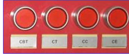
Figura 22 - Pulsadores extinción cuartos técnicos
