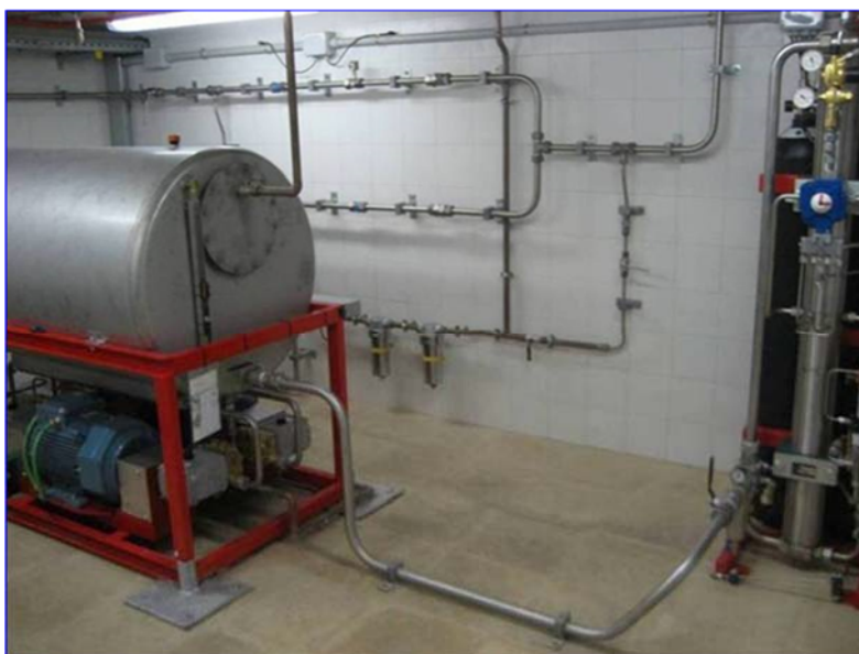
Figura 10 - Cuarto PCI extinción. Cuba almacenaje de agua
