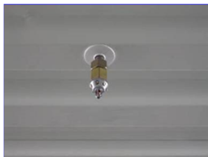
Figura 8 - Boquilla cerrada cuarto no técnico
