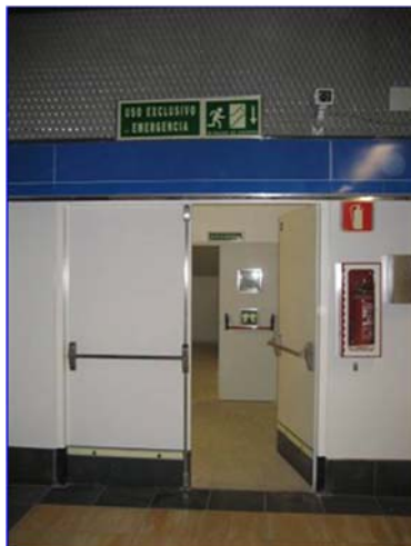
Figura 43 - Balizamiento fotoluminiscente en salida de emergencia de estación
