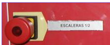
Figura 16 - Seta extinción escaleras mecánicas
