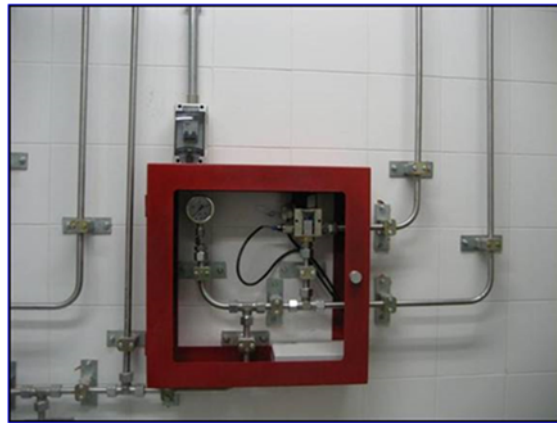
Figura 23 - válvula NS12 extinción cuarto técnico
