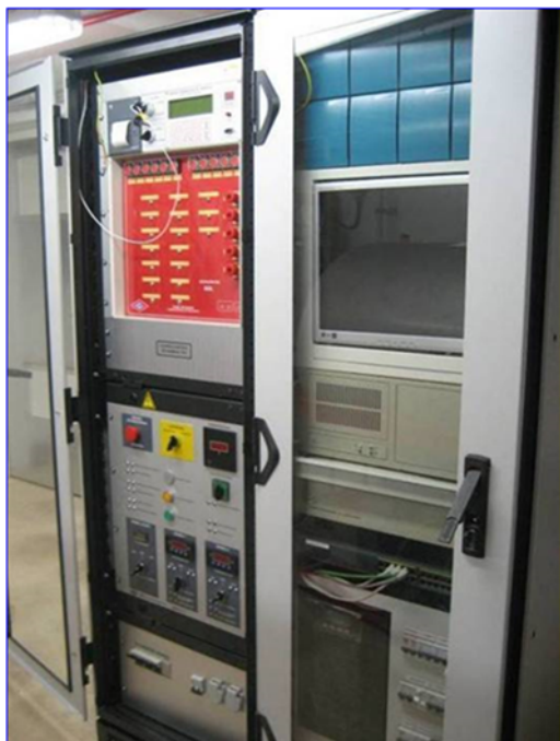
Figura 11 - Panel maestro extinción y cuadro eléctrico bombas
