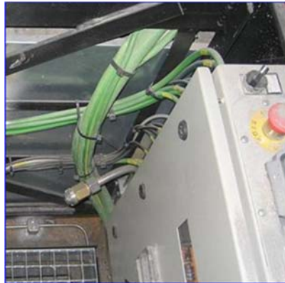
Figura 7 - Boquilla abierta foso escalera mecánica
