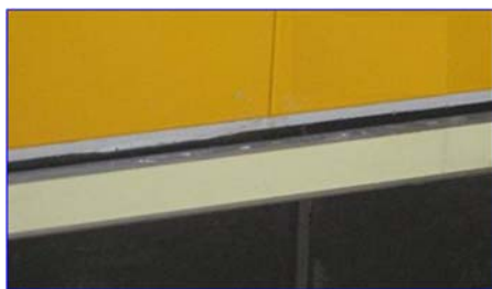
Figura 32 - Balizamiento fotoluminiscente en paramento andén
