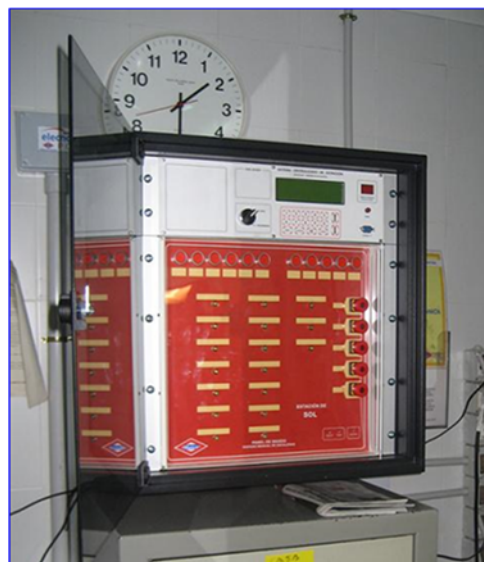
Figura 12 - Panel servidor extinción
