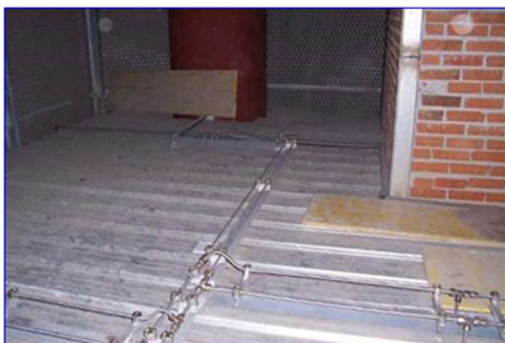
Figura 19 - Tuberías acero inoxidable y soportaciones
