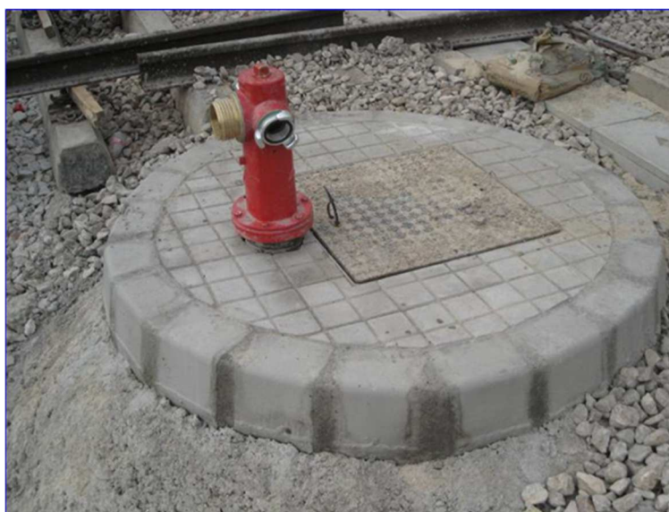
Figura 31 - Hidrante exterior de columna seca
