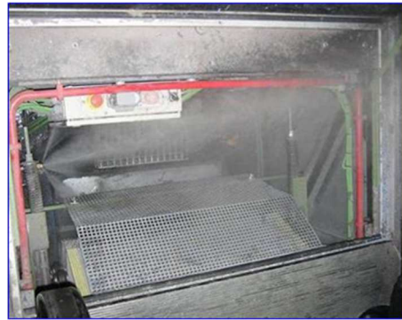
Figura 13 - Extinción en foso escalera mecánica
