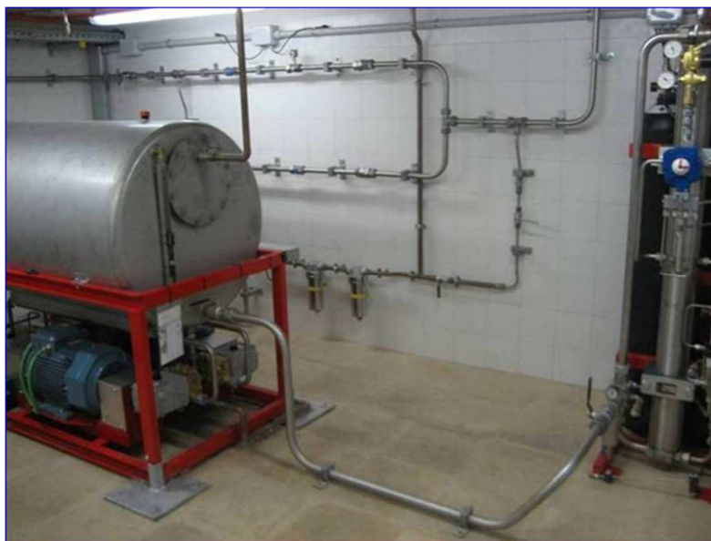
Figura 10 - Cuarto PCI extinción. Cuba almacenaje de agua
