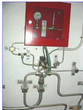
Figura 15 - Válvula extinción NS20 escalera mecánica
