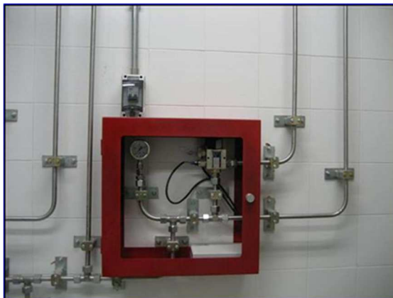
Figura 23 - válvula NS12 extinción cuarto técnico
