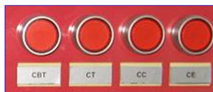
Figura 22 - Pulsadores extinción cuartos técnicos
