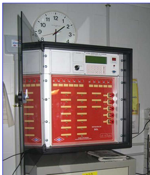
Figura 12 - Panel servidor extinción
