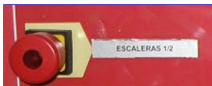
Figura 16 - Seta extinción escaleras mecánicas
