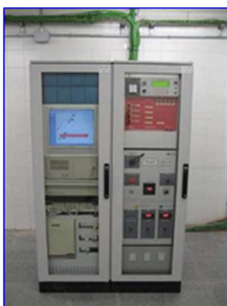
Figura 5 - Cuadros control extinción y equipos integración
