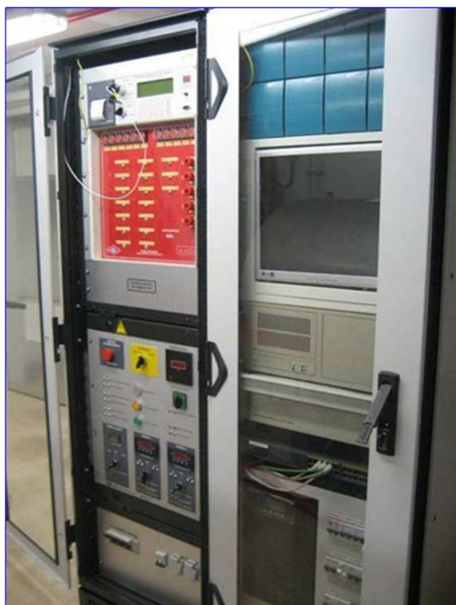
Figura 11 - Panel maestro extinción y cuadro eléctrico bombas
