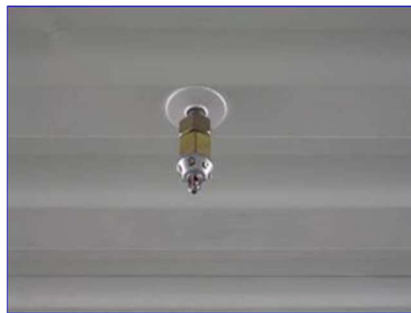
Figura 8 - Boquilla cerrada cuarto no técnico
