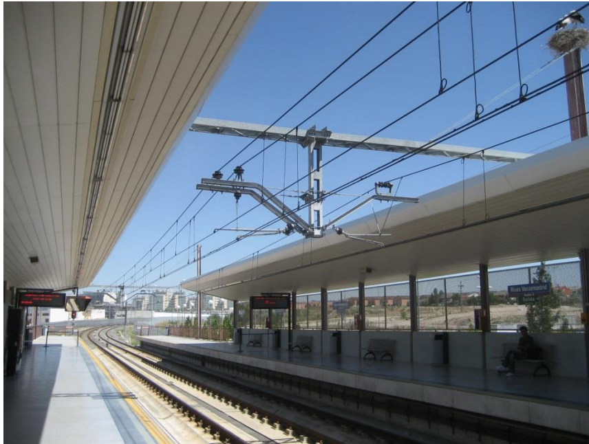
Figura 4: Estación de Línea 9 con catenaria convencional
