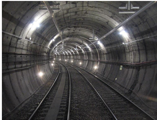
Figura 5: imagen de túnel electrificado con catenaria rígida.
