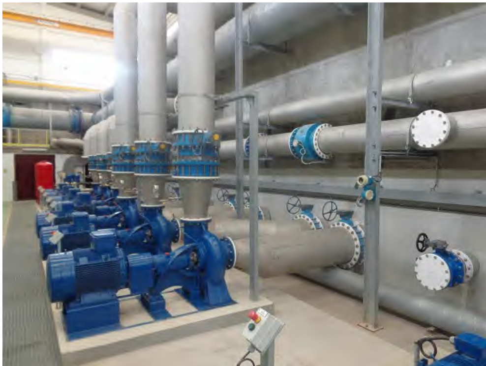
2. Bombeo lavado de filtros
