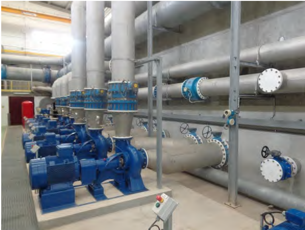
Foto 1. Grupos de bombeo para lavado de filtros
