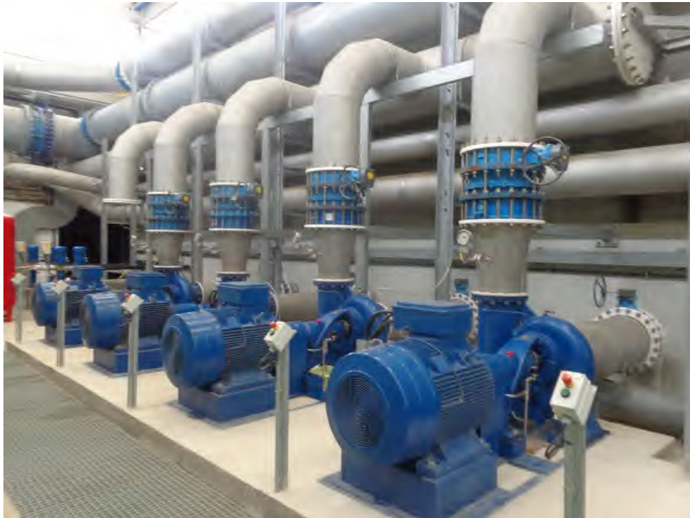
1. Bombeo Fundación Sur
