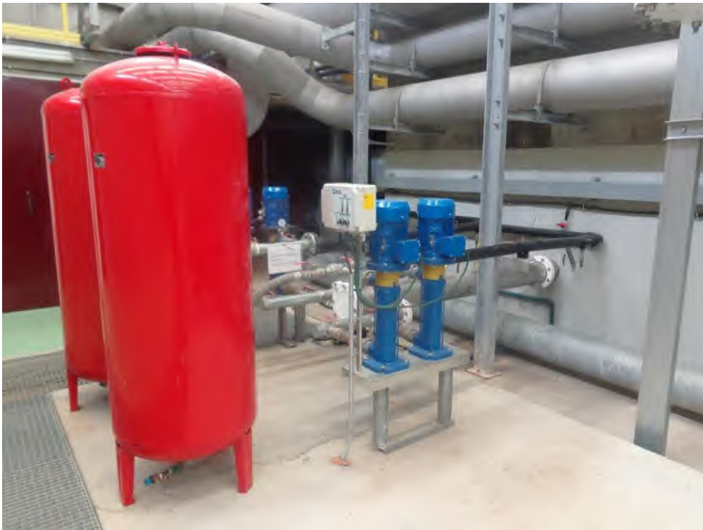
Foto 2. Grupos de bombeo para agua de servicios y dilución de reactivos en E.T.A.P. de Griñón
