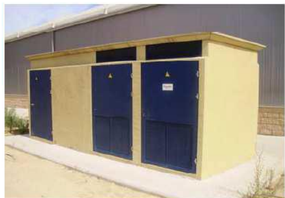
Caseta eléctrica de C.G.B.T
