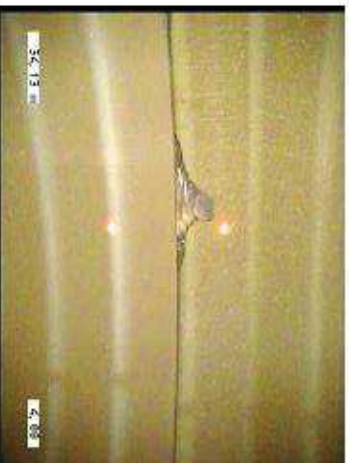
P3_27e61aad-84d0-498c-89bf-c7839f15c6f6_20220426_122328_665.jpg, 00:04:02, 34,13m Micro-fisura longitudinal, anchura de la fisura, 50mm a 11 Reloj / EN LA JUNTA
