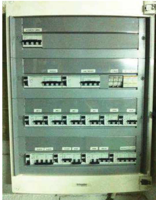
Figura 26: Ejemplo de etiquetado de cuadro eléctrico
