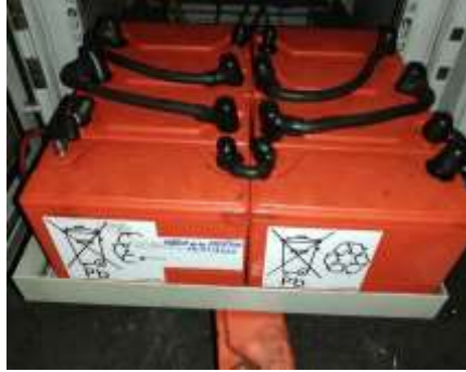
CONJUNTO DE 8 BATERÍAS
