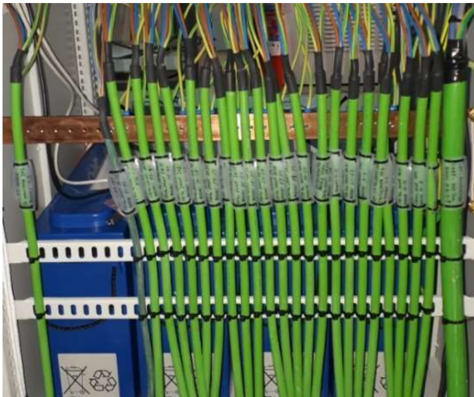
EJEMPLO DE ENTRADA DE MANGUERAS AL ARMARIO.
