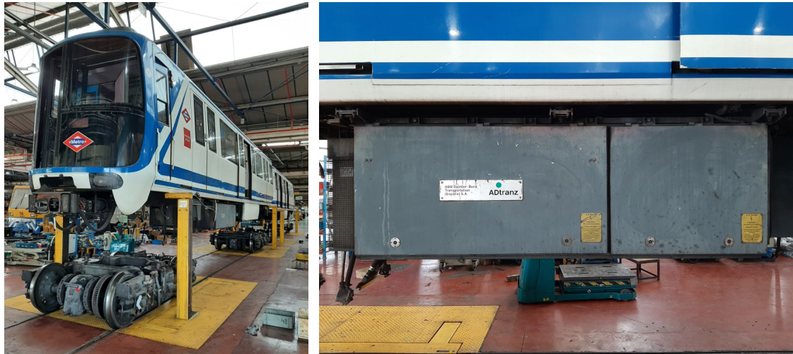
Figura 3. Ubicación del cofre de electrónica de potencia
