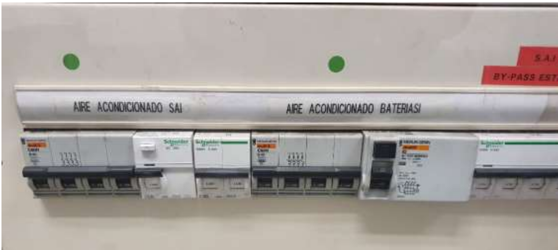
CTI: Servicios de Aire Acondicionado en actual Cuadro de Maniobras de SAIs
