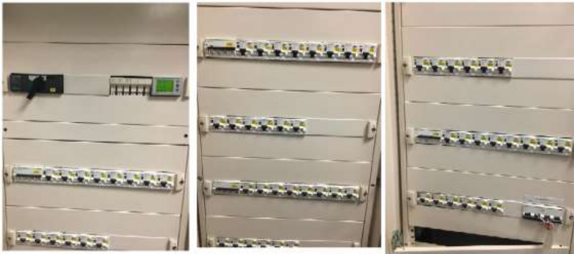
Cuadros de Distribución existentes de SAI A en CPD 1
