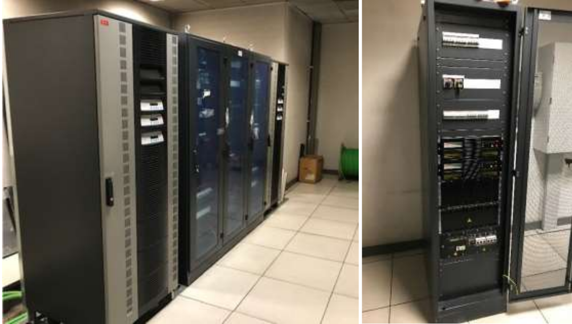
TICS Vista general de SAI A y B (a la izquierda), y SAI C (a la derecha)
