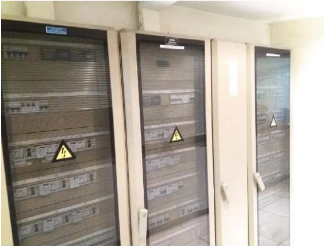
Cuadros existentes en Pasillo, cercano a CPD 1
