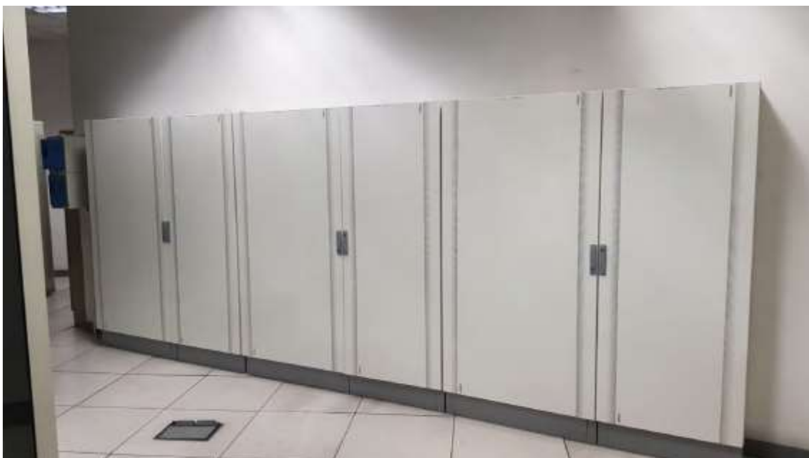
TICS Vista general de los cuadros A, B y C del CPD de la planta Alta (similar a los cuadros del CPD de la planta baja)
