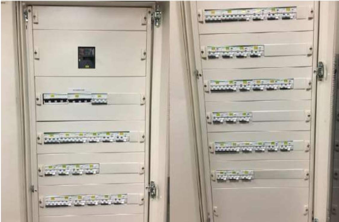
Cuadros de Distribución existentes de SAI B en CPD 1
