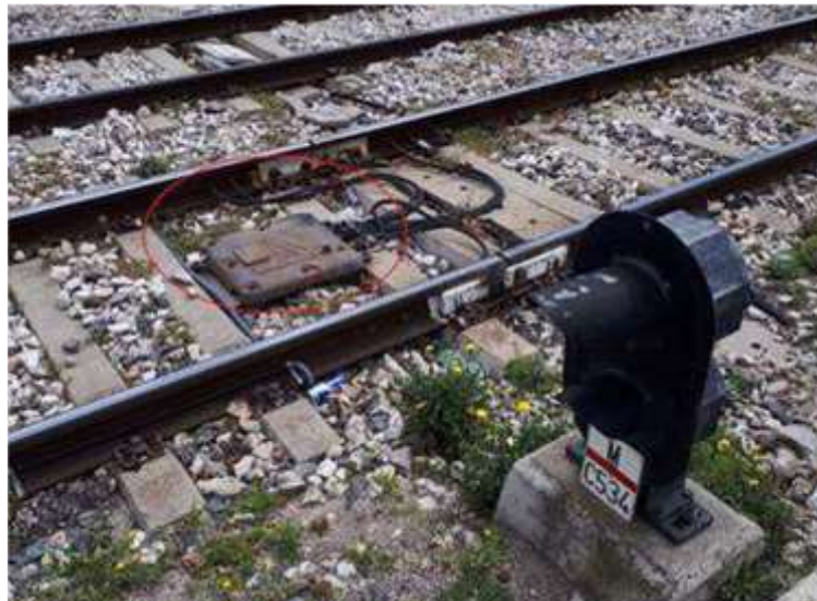
Ilustración 1 Junta inductiva instalada
