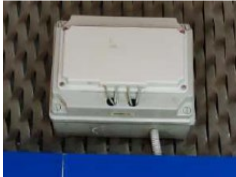
Ejemplo de instalación de antena exterior y AP en caja de PVC
