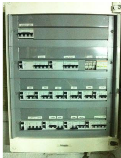
Ejemplo de etiquetado de cuadro eléctrico
