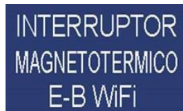
Estación Base y AP WiFi - Rotulación del magnetotérmico
