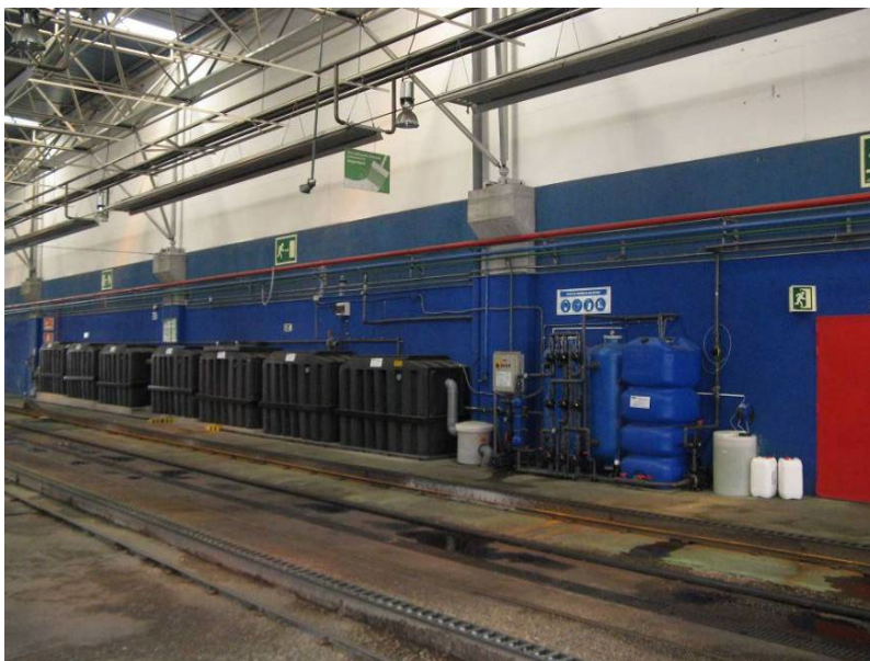
RECICLADORA AGUACLEAN: instaladas en los túneles de lavado de Laguna
