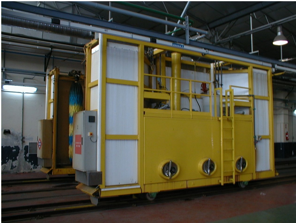
Detalle del túnel de lavado igual o similar a los instalados en los túneles de: HORTALEZA 4, FUENCARRAL, y PUERTA ARGANDA
